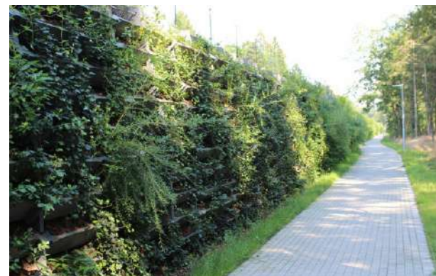
ÉCRAN ACOUSTIQUE VÉGÉTAL SOURCE : TECHNI-CONTACT
